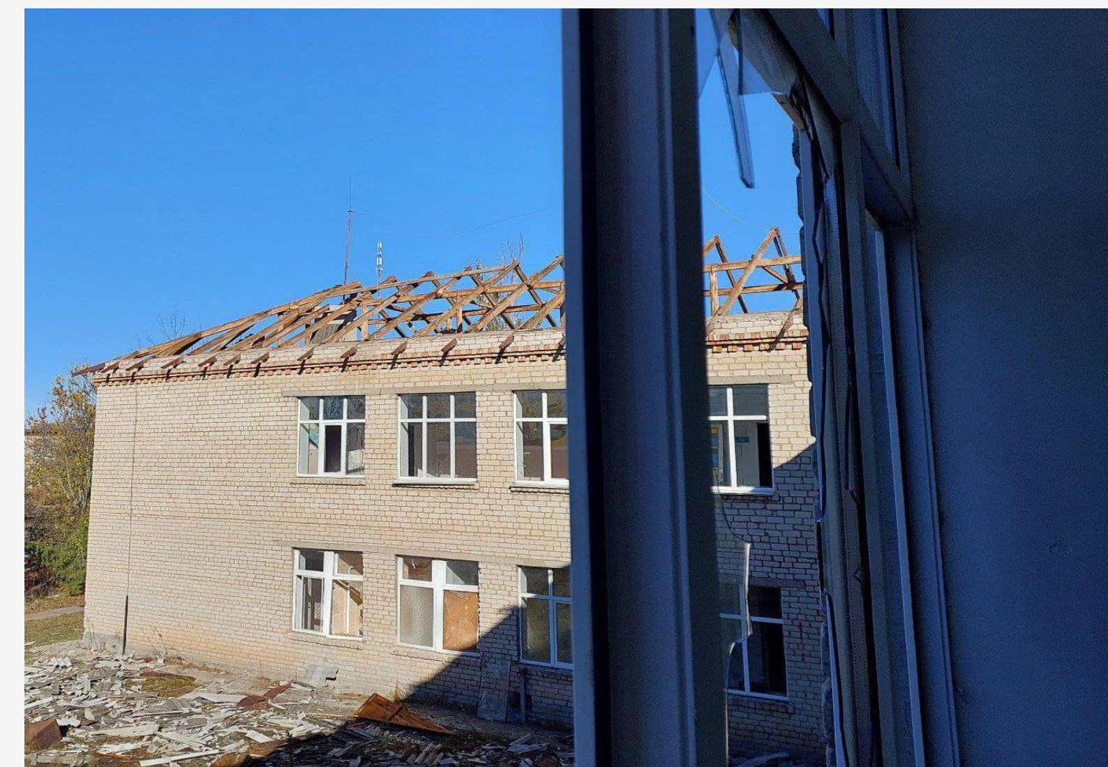
Budynek szkoły we wsi Szewczenkowe, który został uszkodzony w wyniku ostrzałów
