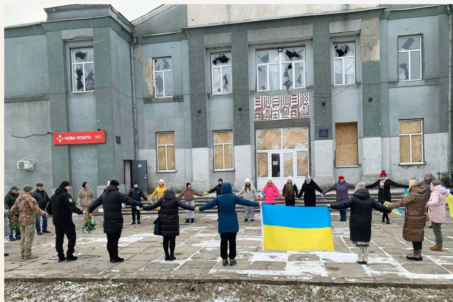
Uszkodzony budynek Centrum Kultury i Rozrywki
