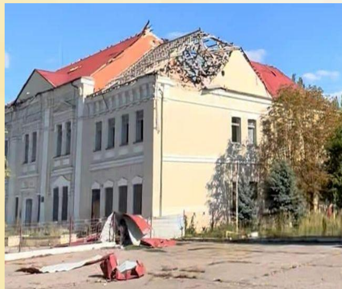
Uszkodzony budynek liceum. Budynek o znaczeniu historycznym
