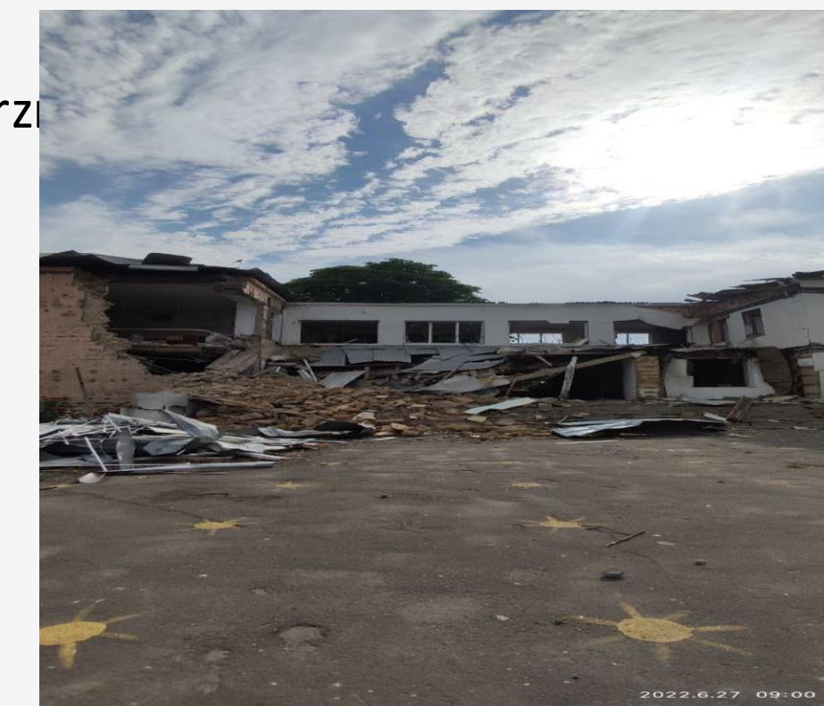
Zniszczone liceum w Bereznehuwatem
