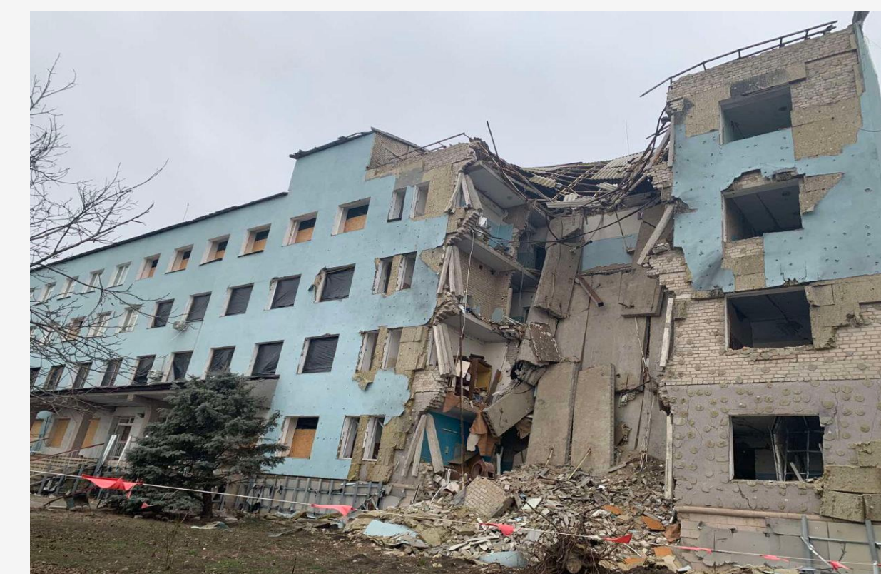
Uszkodzony budynek szpitala
