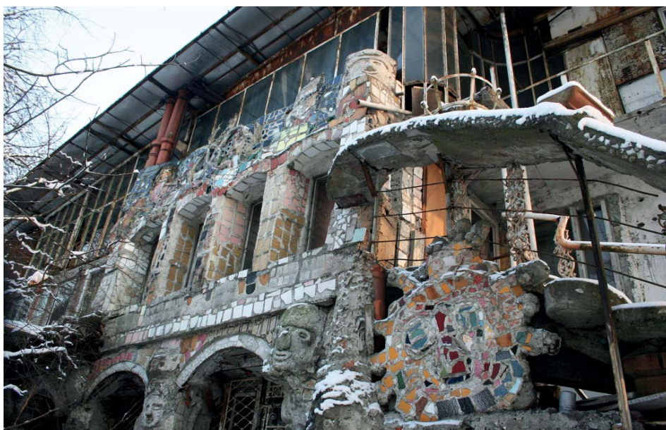
Niszczyjąca elewacja willi Tahiti Fot. Lidia Głazewska-Dańko
