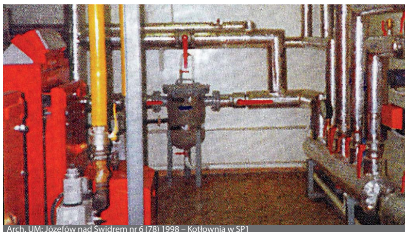
Arch. UM: Józefów nad Świdrem nr 6 (78) 1998 – Kotłownia w SP1
